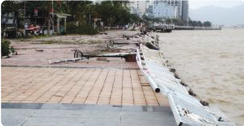
Hình 5.5. Bão số 11 năm 2013 làm đổ lan can đường Bạch Đằng, Đà Nẵng
