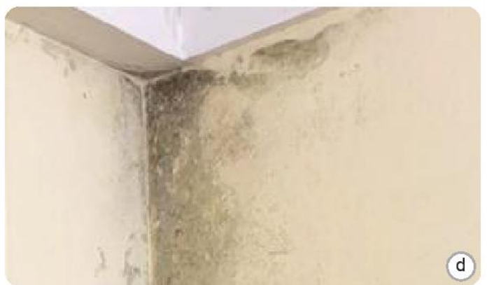
Nấm mốc ở góc tường nhà
