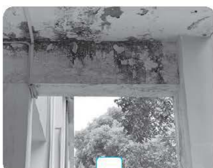
Tường và trần nhà, nơi ẩm thấp
