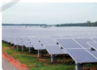
Nhà máy điện mặt trời Bình Thuận
