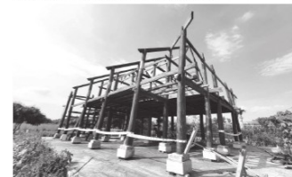
Một công trình tại dự án vườn sinh thái Hoa Bay đang bị xử lý. Ảnh: TP
