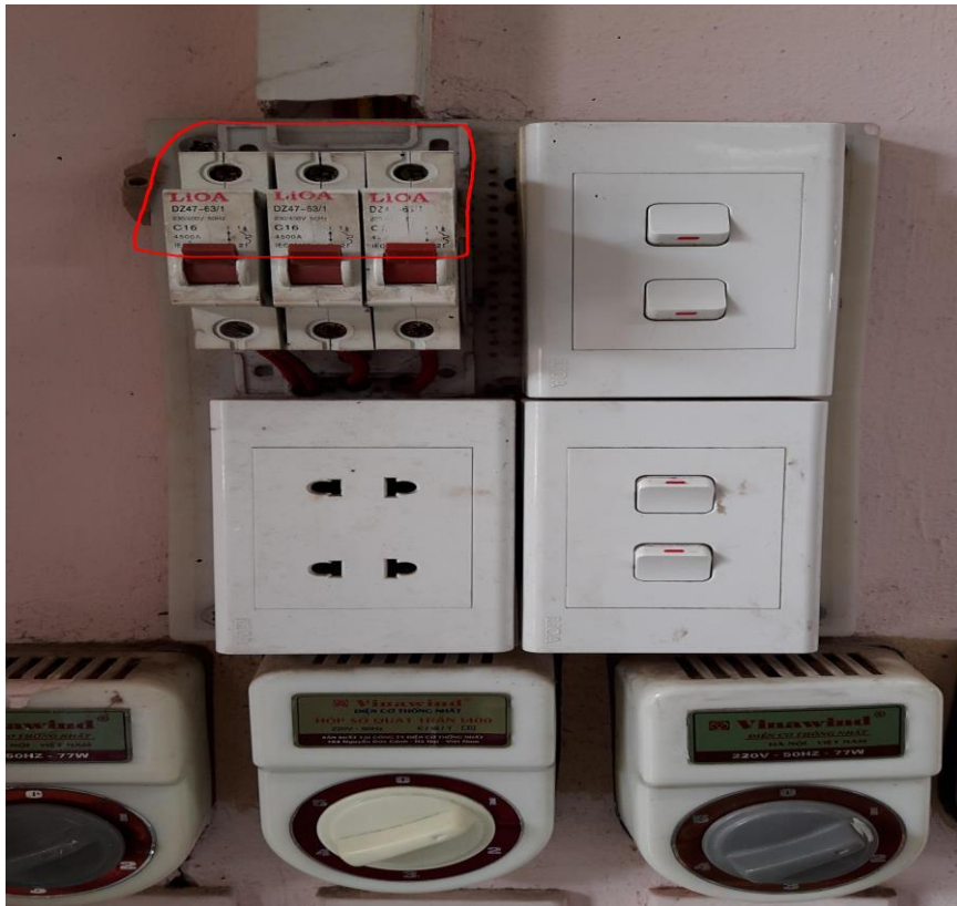
Bảng điện không an toàn
