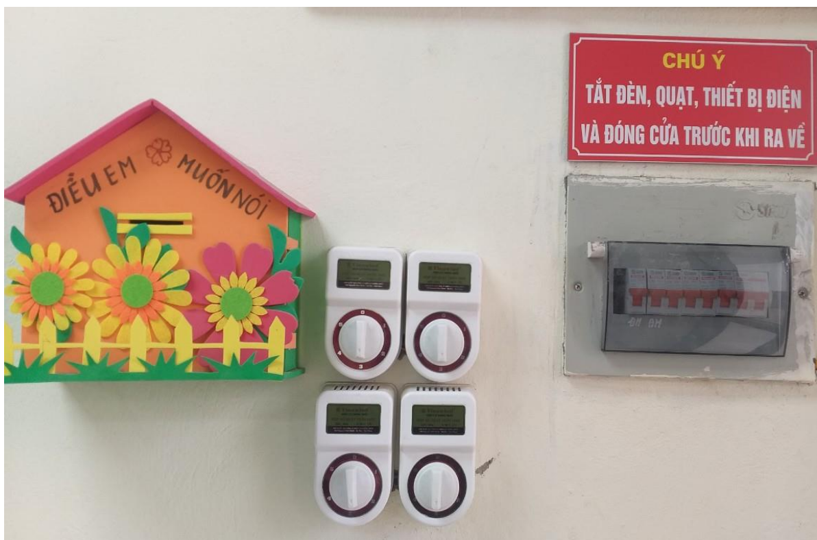
Bảng điện an toàn
