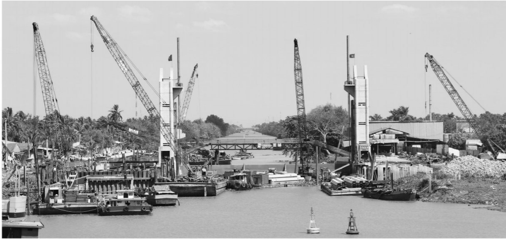
Cống âu Nguyễn Tấn Thành vận hành đóng ngăn mặn chính thức vào đầu tháng 3/2024.
