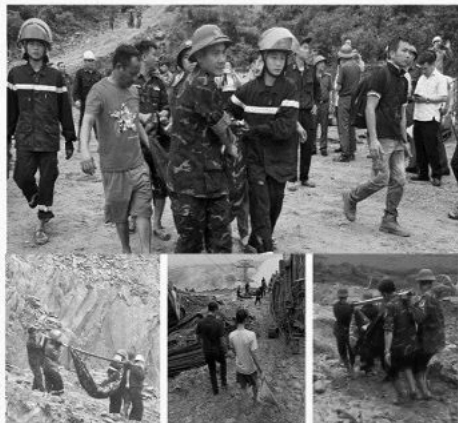
Toàn cảnh khu vực có sự cố sạt lở tại khu vực móng trụ số 28, dự án đường dây 500Kv Quảng Trạch - Quỳnh Lưu.
