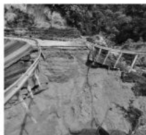
Mưa lớn gây sạt lở đường (Quốc lộ 40), đoạn qua thôn Tả Lùng, xã Tả Lùng (ảnh Báo Giao thông).
