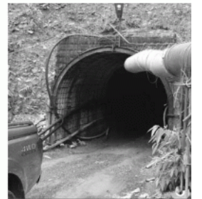
Cửa hầm, nơi xảy ra vụ việc. Nguồn ảnh: Công 1
