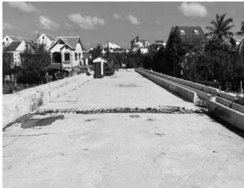
Dự án cầu Thanh Nam qua sông Thu Bồn, tại TP. Hội An, tỉnh Quảng Nam chưa thể đưa vào sử dụng do chưa hoàn thành đường dẫn. (Ảnh: Báo Chính phủ).
