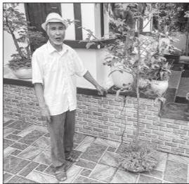
Các vết nứt trong khu vườn, tường rào và nhà dân, kéo dài từ đầu xóm Bãi đến cuối xóm.
