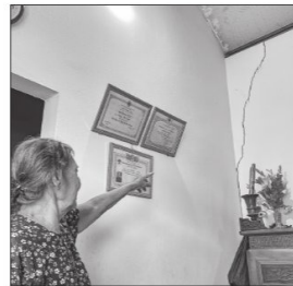
Ở xóm Bãi, người dân lo lắng vì chưa bao giờ chứng kiến lòng sông bị tụt sâu đến thế.
