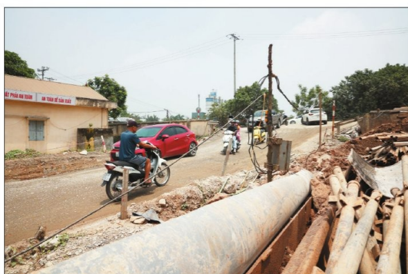
Dây điện, cọc sắt đường di chuyển của người dân.
