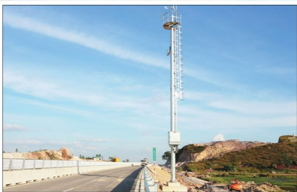
Hệ thống giao thông thông minh trên tuyến cao tốc.
