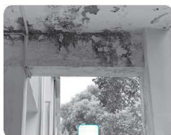
Tường và trần nhà, nơi ẩm thấp
