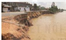
▲ Hình 6. Sụt lún đất ven sông (tỉnh An Giang)
