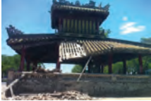
Hình 6. Mái Phủ Văn Lâu bị sập
