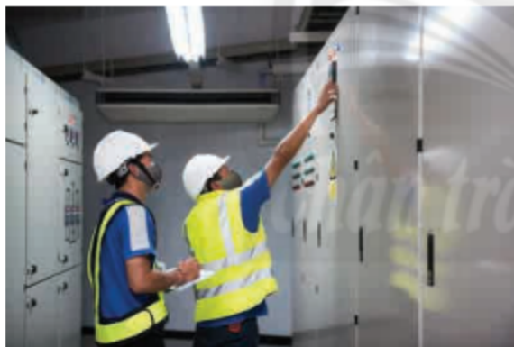
a) Vận hành hệ thống điện
