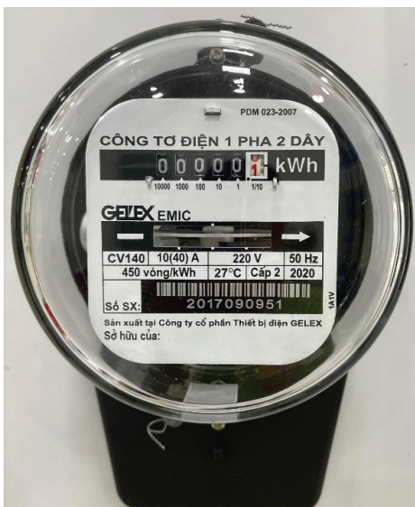
Công tơ điện 1 pha
