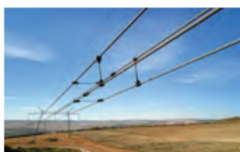
▲ Hình 16.2. Dây dẫn truyền tải điện
