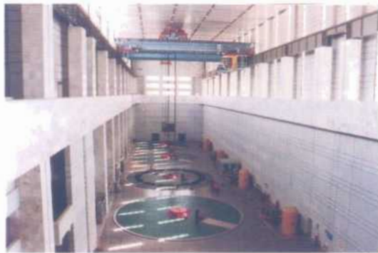
Gian Tuabin (Nhà máy Thủy điện Trị An)
