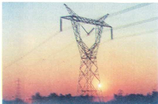
Hình 32.4. Đường dây truyền tải điện cao áp
