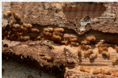
Mối phá hoại công trình xây dựng
