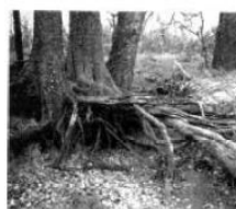
River erosion Xói mòn sông
