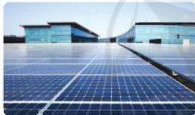
Hình 9.5. Nhà máy sản xuất năng lượng mặt trời
