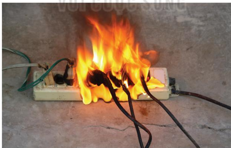
Hình 8.1. Cháy có thể xảy ra do chập điện
