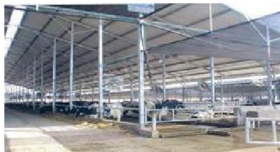
Hình 17.6. Hệ thống chuồng bò sữa có lắp đặt quạt mát
