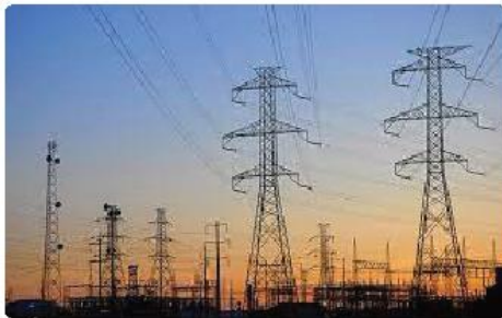
Đường dây điện cao thế.
