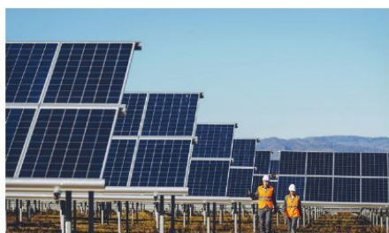
a) Nhà máy điện mặt trời
