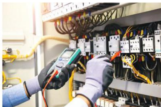
c) Bảo trì thiết bị điện
