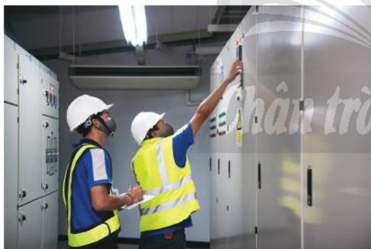
a) Vận hành hệ thống điện
