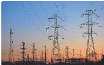
Đường dây điện cao thế
