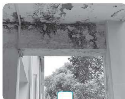
Tường và trần nhà, nơi ẩm thấp
