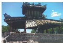
Hình 6. Mái Phủ Văn Lâu bị sập
