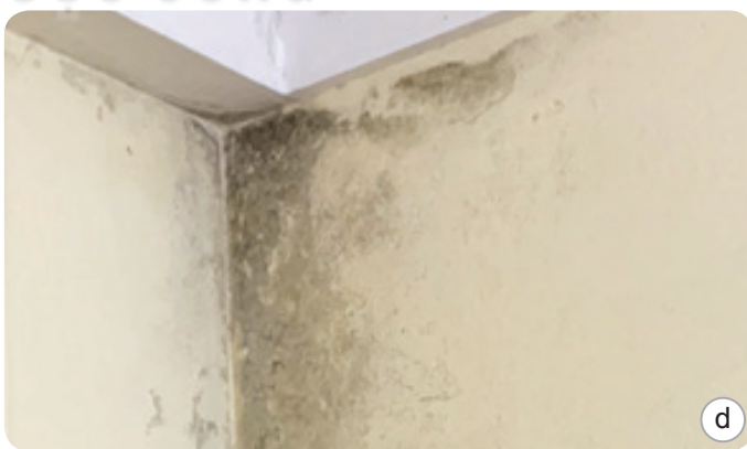
Nấm mốc ở góc tường nhà
