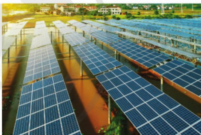
Hình 12.4. Nhà máy điện mặt trời
